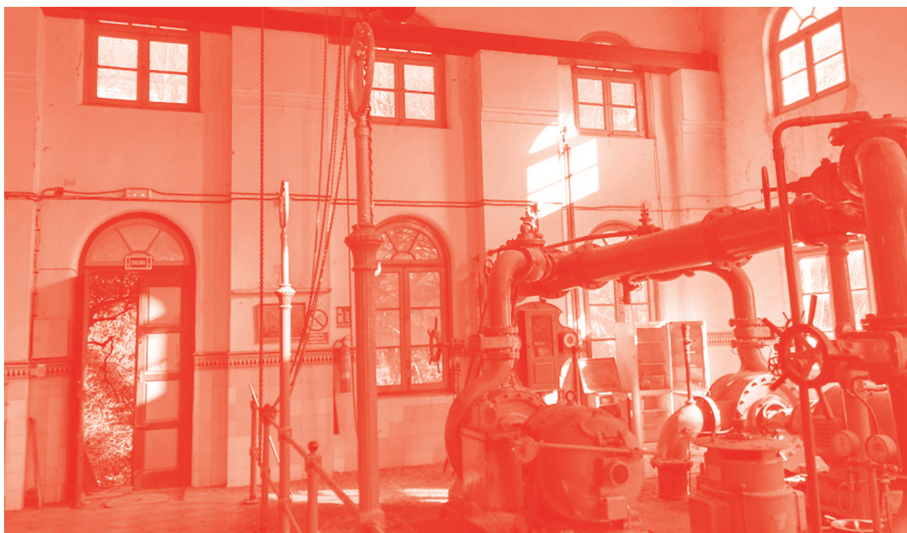
Fig. 2: Sala de bombas en la Estación de bombeo de agua de Adufe en Alcalá Guadaíra
